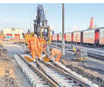
Am Bad Doberaner Bahnhof wurden 2021 unter anderem zwei alte Weichen durch Neubaueichen ausgetauscht. FOTO: MBB MOLLI GMBH
